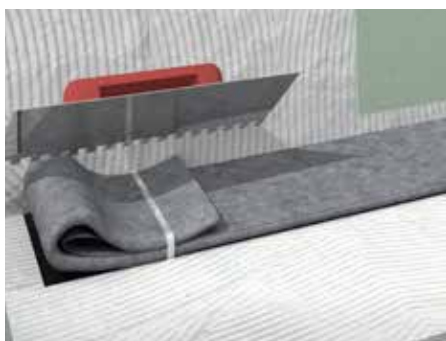
11. Adherir con cemento cola clase C2 S1/S2 sobre encuentros y pendientes la banda ECODRY BANDA termosellada al LINEAL/SUMI LEVEL .
